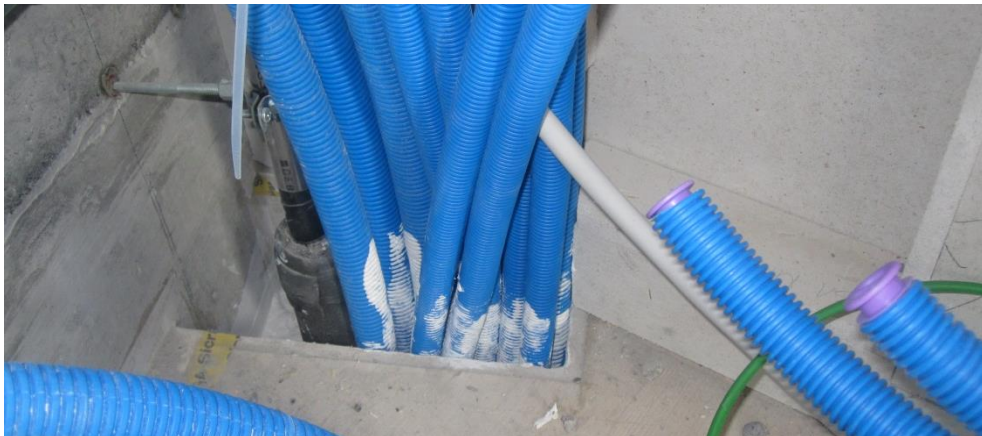
Abbildung 9: Nicht geeignet: Gebündelte Elektroinstallationen (Quelle: Hochschule Luzern – Technik & Architektur; Foto: 30.11.2013)
